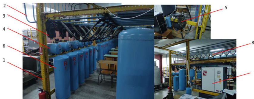
Фиг. 2.1 Общ вид на стенд за газодинамични изследвания на спирачните системи: 1 – носеща конструкция; 2 – въздуховоди; 3 – функционален вентил тип KE1; 4 – спирачен цилиндър; 5 – кран-машинист Knorr D2; 6 – запасен резервоар; 7 – компресор; 8 – манометри.
